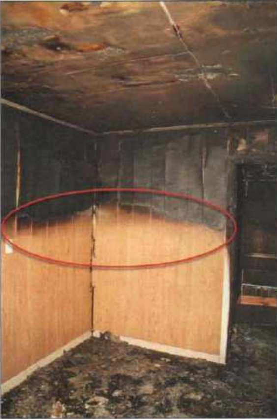
Imagen 20.9 El cielo raso y las paredes superiores de esta habitación fueron dañados por el calor, mientras que las áreas inferiores nunca alcanzaron temperaturas dañinas.
