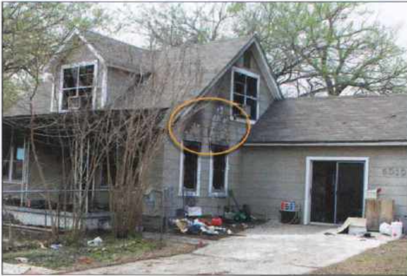
Imagen 20.7 Los bomberos deberían buscar patrones de ventilación y fuego alrededor de las ventanas y puertas de una edificación. Cortesía de Donny Howard, Agente, Oficina del Jefe de Bomberos del Estado de Oklahoma.
