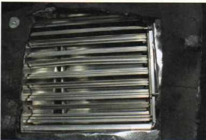
Imagen 16.21 Ejemplo de una compuerta bloqueadora de humo dentro de un conducto de HVAC.
