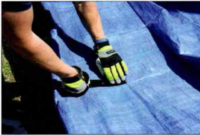
Imagen 15.27 Un bombero aplicando cinta para ductos para reparar un corte en una cubierta de salvamento de vinilo.
