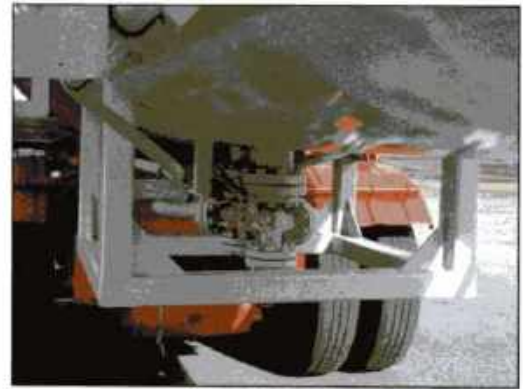
Imagen 24.103 Los autotanques de alta presión tienen una caja estructural que protege los conectores ubicados en la parte inferior. Cortesía de Barry Lindley.
