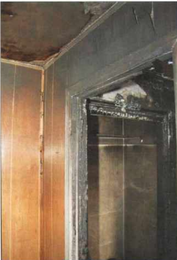
Imagen 20.11 La carbonización intensa en el lado derecho de la foto indica que el área o el punto de origen se encuentra en esa dirección.
