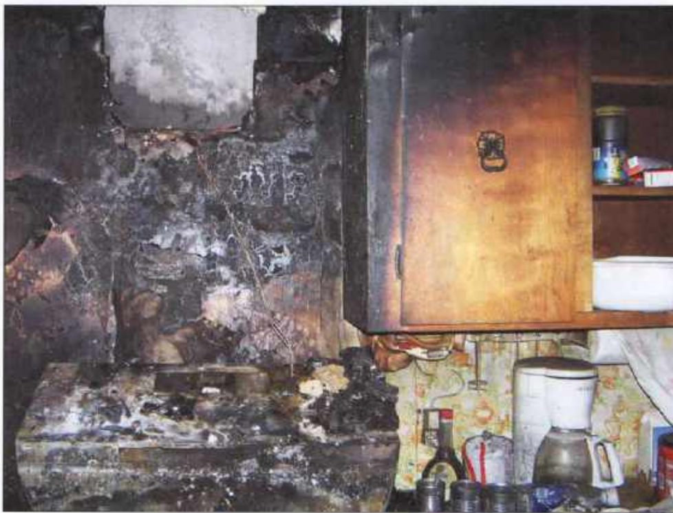
Imagen 20.4 Escombros que pueden indicar la causa de este incendio. Foto cortesía de Nicole Fuge, Portland Fire Investigations.
