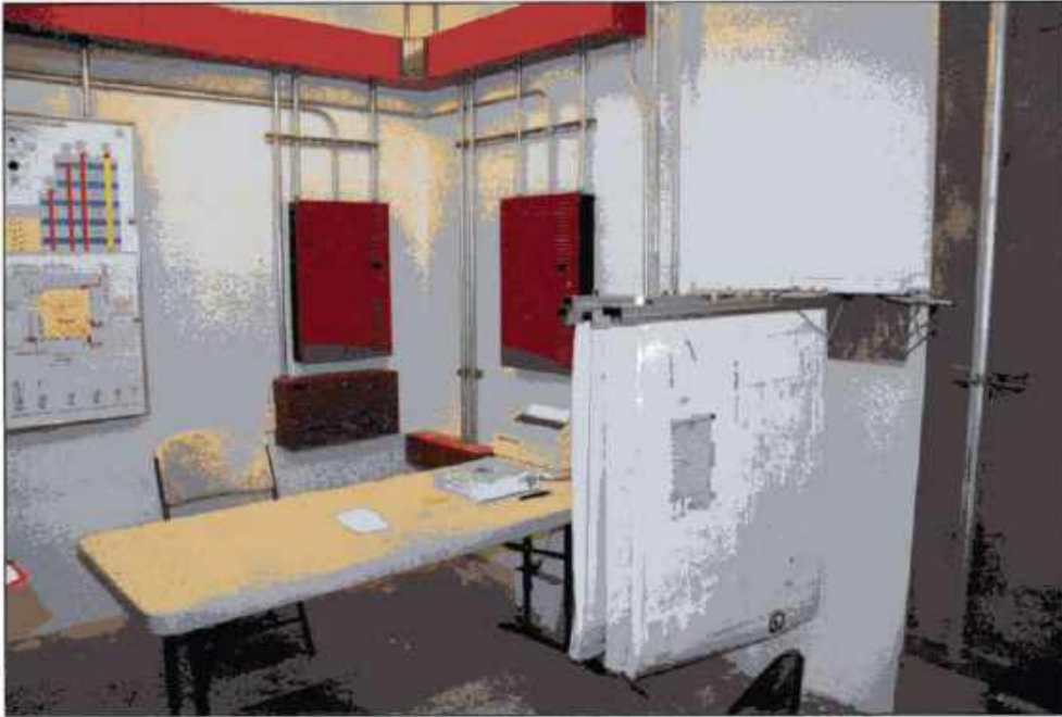
Imagen 22.15 El centro de comando de incendios en una estructura de apartamentos de varios pisos.
