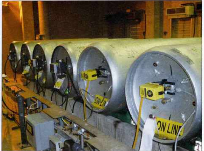
Imagen 26.65 NO cierre válvulas sin la dirección de los operarios de la instalación o de las tuberías. El cierre de válvulas sin guía experta puede tener consecuencias potencialmente peligrosas. Cortesía de la Comisión de Protección Contra el Fuego de Texas.
