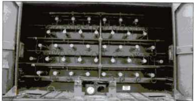
Imagen 24.108 Las válvulas de los cilindros del remolque para cilindros de gas comprimido están conectadas entre sí ( manifolded ).
