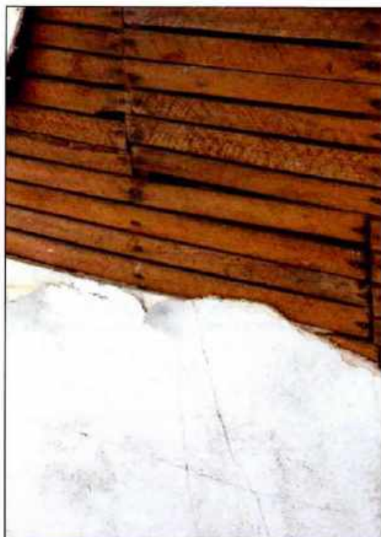
Imagen 16.11 Una pared de listones y enlucidos dañada en una edificación antigua abandonada.
