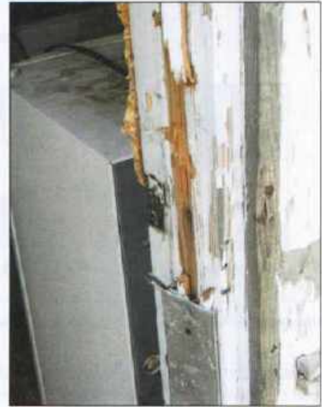
Imagen 20.8 El daño a este marco de puerta indica que alguien forzó la entrada a través de esta puerta.
