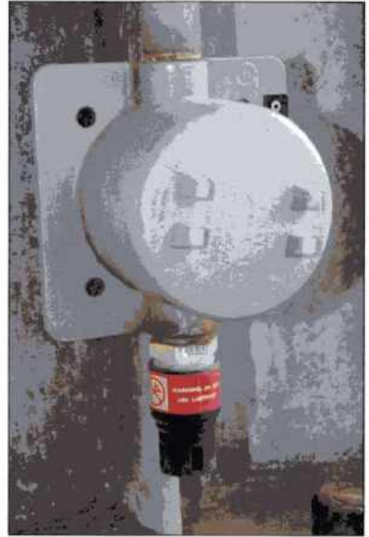
Imagen 22.20 Detectores de gas de incendios como este se usan en refinerías y otras instalaciones de manufactura donde se generan o usan gases inflamables.
