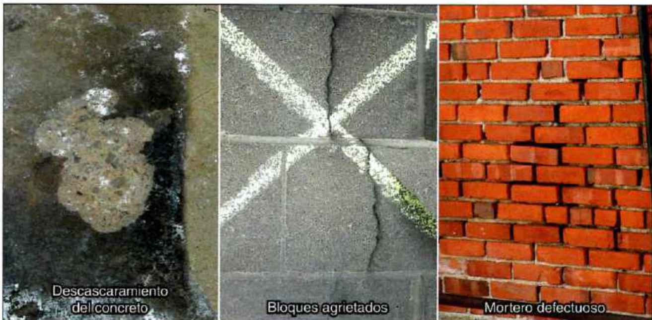
Imagen 16.3 Tres de los tipos comunes de daños que ocurren en piedras y concreto.
