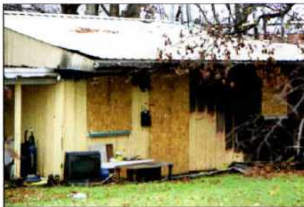
Imagen 15.25 Las aberturas de esta edificación se han cubierto con láminas de madera contrachapada para proteger de la lluvia y evitar el acceso a la gente.
