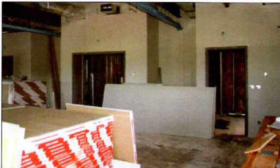
Imagen 16.10 Pilas de placas de paneles de yeso ( drywall ) en una edificación en construcción.
