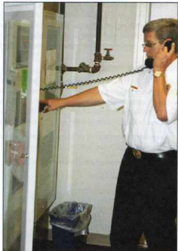
Imagen 17.13 Un oficial de bomberos probando un sistema telefónico de emergencia en la sala de máquinas de un edificio.
